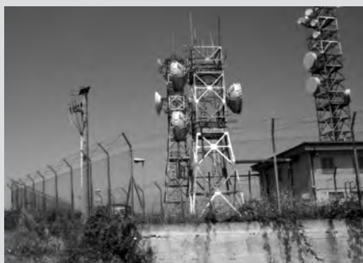
Antenne per telecomunicazioni nel Comune di Spilinga - Monte Poro (VV)
